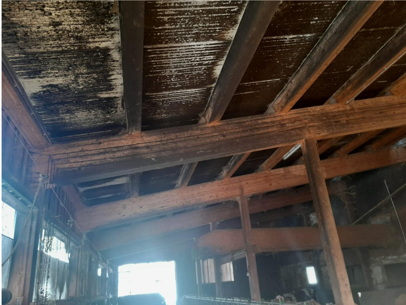
Verfärbungen der Dachunterseite
